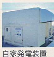
自家発電装置
